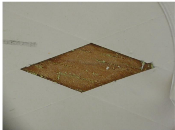
Verwijderd verfsysteem na 24 uur vochtbelasting.
